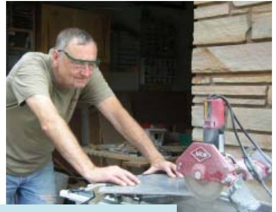
Un obrero de construcción usa una sierra de corte húmedo para cortar una baldosa cerámica de sílice.
